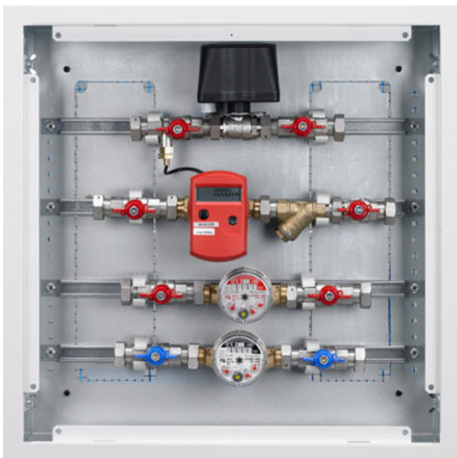
con contatori acqua sanitaria calda e fredda
